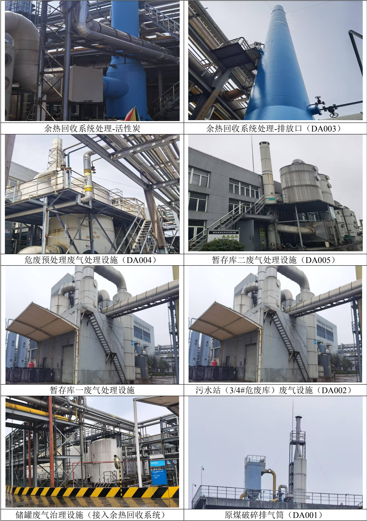
图 4.1-5 废气处理设施照片
