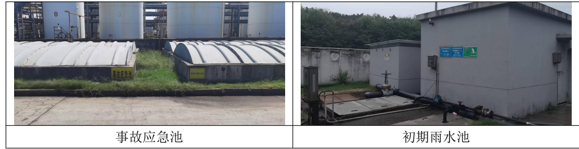
图 4.2-1 厂区内事故应急池（1600m 3 ）和初期雨水池（400m 3 ）设置情况
